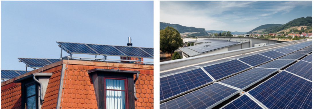
Abb. 3.6: PV-Module bei Flachdächern. Links: südlich ausgerichtete Anlage. Rechts: Anlagen in Ost-West-Ausrichtung (Fotos: Alexander Maack, Elektro Prinzbach GmbH)
