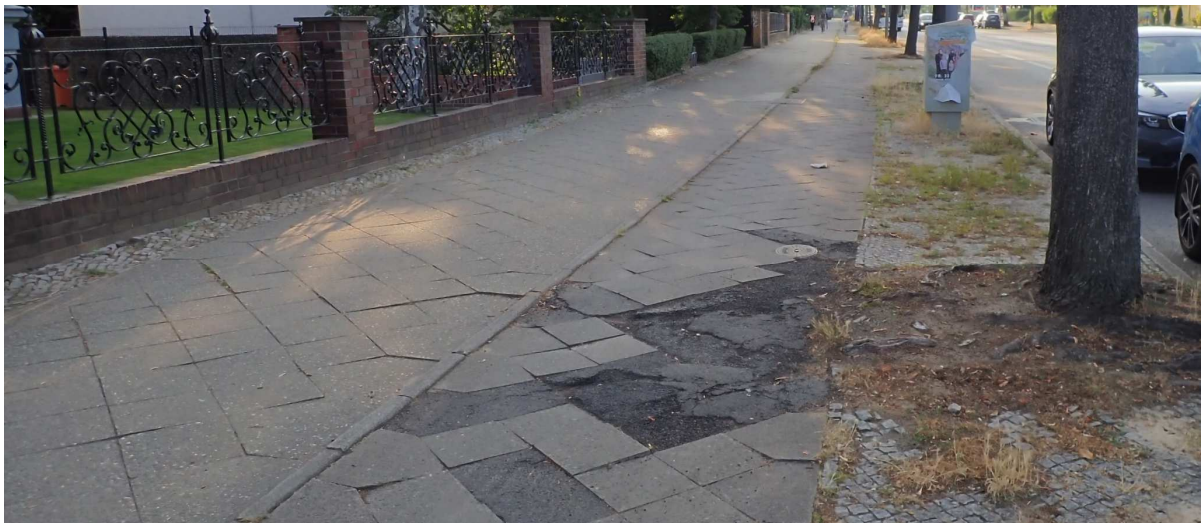
Abbildung 37: Wurzelschäden auf dem Radweg Königsberger Str. (eigene Aufnahme)
